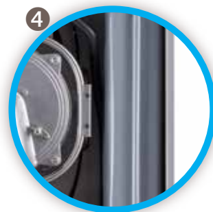
Vaso espansione riscaldamento
