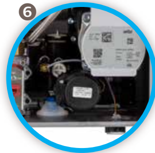
Valvola 3 vie posta sul ritorno riscaldamento
